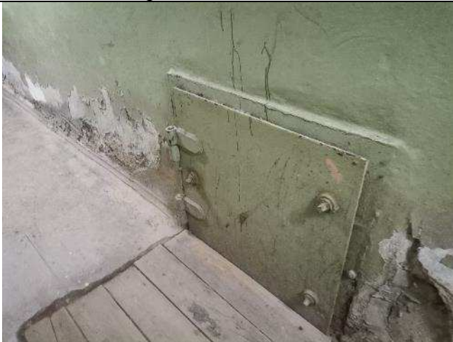
Фото 25. Места разрушения штукатурки и окраски отделочного слоя внутренней поверхности стен подвала
