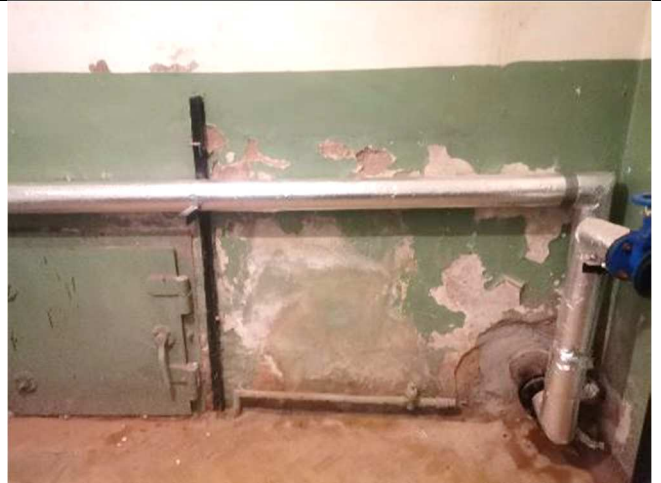
Фото 22. Места замачивания наружных стен в уровне подвала. Места разрушения штукатурки и окраски отделочного слоя внутренней поверхности стен подвала
