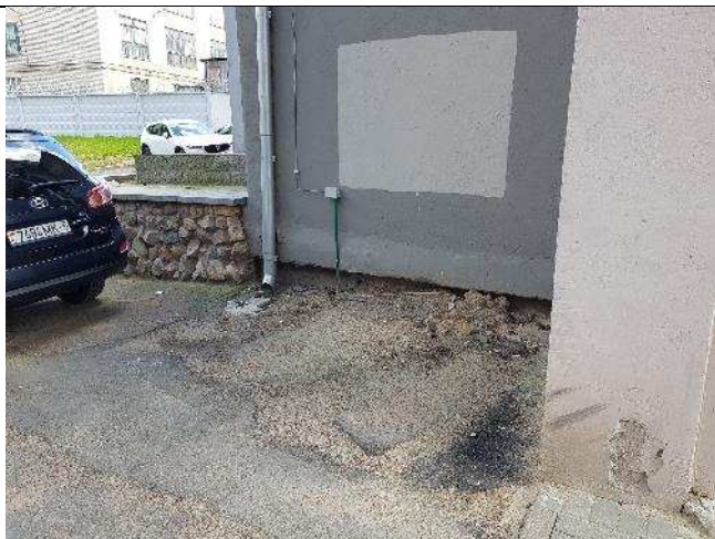
Фото 11. Места разрушения, трещины, просадки асфальтобетонной отмостки
