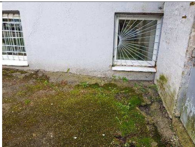
Фото 12. Места разрушения, трещины, просадки асфальтобетонной отмостки, места произрастания растительности
