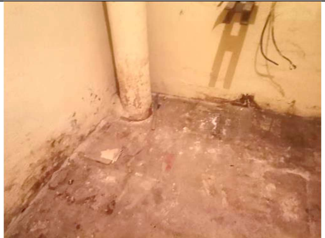
Фото 28. Места замачивания стен в уровне подвала. Места разрушения штукатурки и окраски отделочного слоя внутренней поверхности стен подвала
