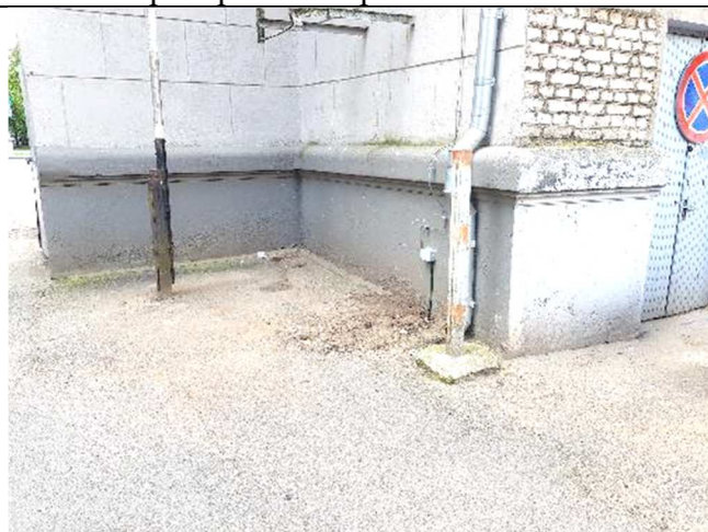
Фото 14. Места разрушения, трещины, просадки асфальтобетонной отмостки, места произрастания растительности
