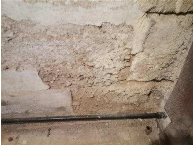
Фото 21. Места разрушения бетона блоков, монолитного бетона стен подвала (низкая прочность бетона вследствие вымывания цементного камня в теле бетона, бетон крошится, отслаивается при простукивании)
