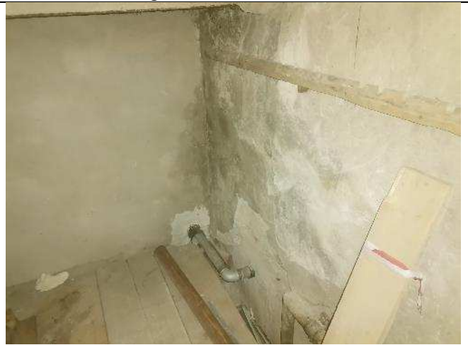
Фото 32. Места замачивания стен в уровне подвала
