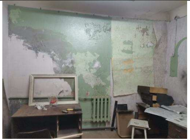
Фото 30. Места замачивания наружных стен в уровне подвала. Места разрушения штукатурки и окраски отделочного слоя внутренней поверхности стен подвала
