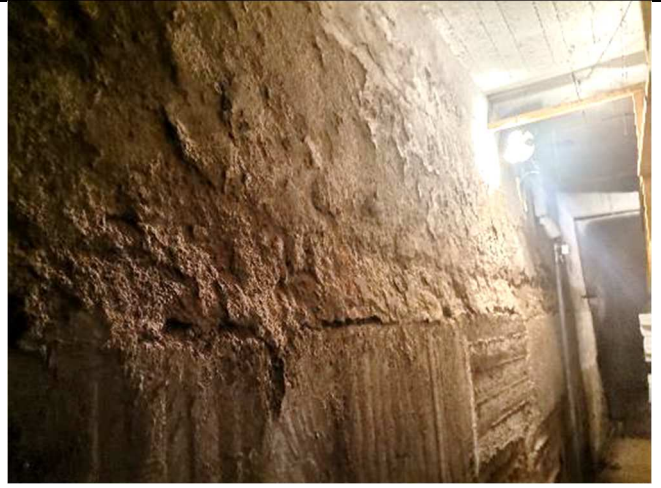
Фото 20. Места разрушения штукатурки и окраски отделочного слоя внутренней поверхности стен подвала. Места разрушения бетона блоков, монолитного бетона стен подвала (низкая прочность бетона вследствие вымывания цементного камня в теле бетона, бетон крошится, отслаивается при простукивании)
