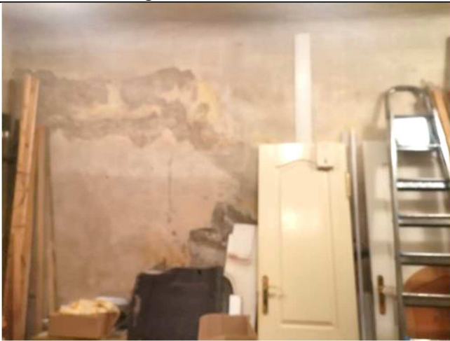
Фото 31. Места замачивания стен в уровне подвала. Места разрушения штукатурки и окраски отделочного слоя внутренней поверхности стен подвала
