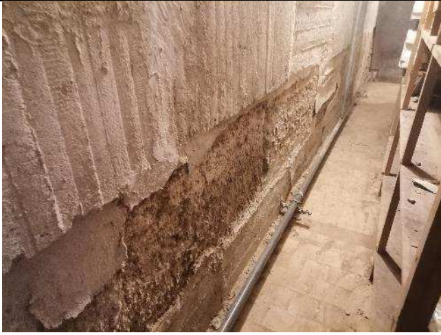
Фото 19. Места разрушения штукатурки и окраски отделочного слоя внутренней поверхности стен подвала. Места разрушения бетона блоков, монолитного бетона стен подвала (низкая прочность бетона вследствие вымывания цементного камня в теле бетона, бетон крошится, отслаивается при простукивании)
