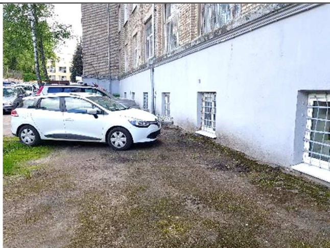
Фото 13. Места разрушения, трещины, просадки асфальтобетонной отмостки, места произрастания растительности
