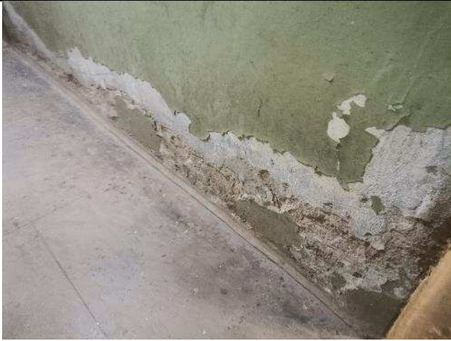
Фото 23. Места разрушения штукатурки и окраски отделочного слоя внутренней поверхности стен подвала
