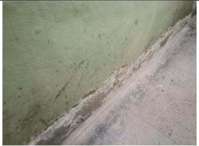
Фото 24. Места разрушения штукатурки и окраски отделочного слоя внутренней поверхности стен подвала
