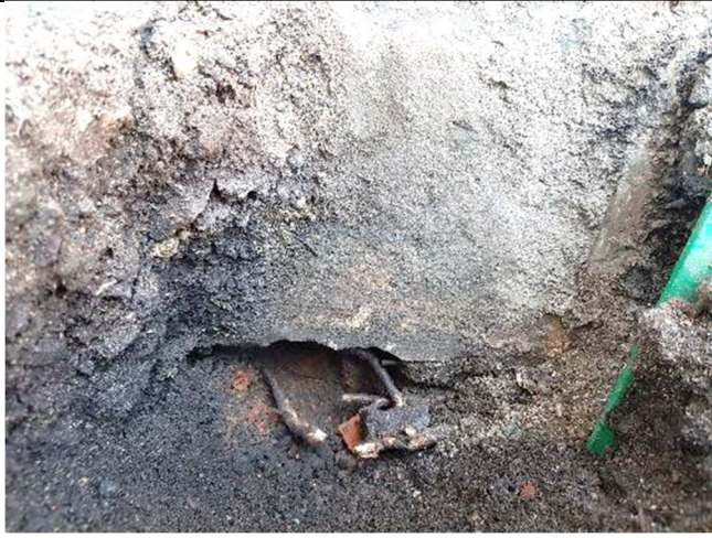
Фото 15. Вертикальная обмазочная гидроизоляция фундаментов разрушена повсеместно
