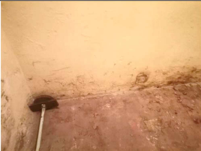
Фото 27. Места замачивания стен в уровне подвала. Места разрушения штукатурки и окраски отделочного слоя внутренней поверхности стен подвала
