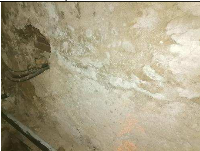
Фото 33. Места разрушения бетона блоков, монолитного бетона стен подвала (низкая прочность бетона вследствие вымывания цементного камня в теле бетона, бетон крошится, отслаивается при простукивании)
