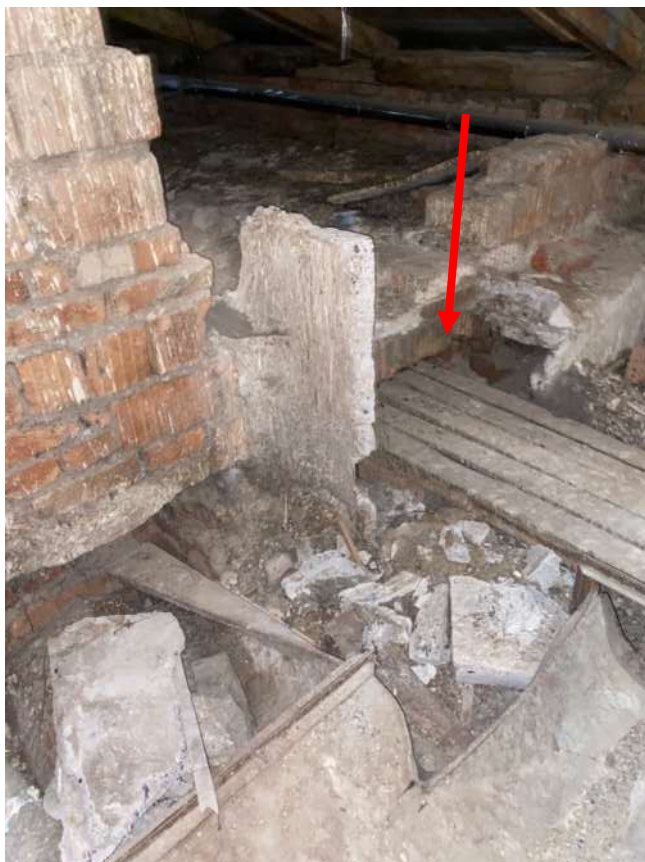
Фото 66. Разрушение бетонного вентиляционного канала в уровне чердака в осях В-Г/3
