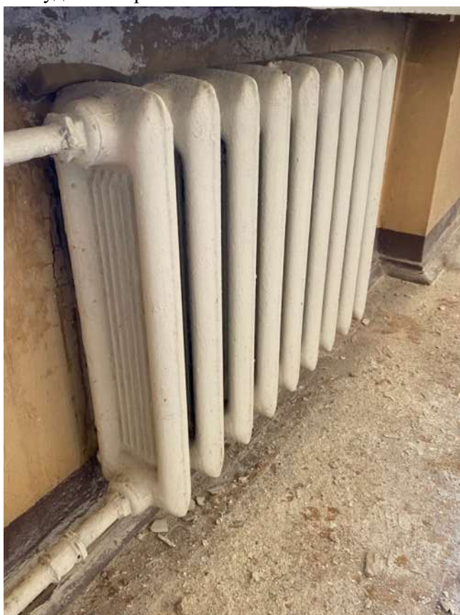
Фото 94. Общий вид радиатора отопления
