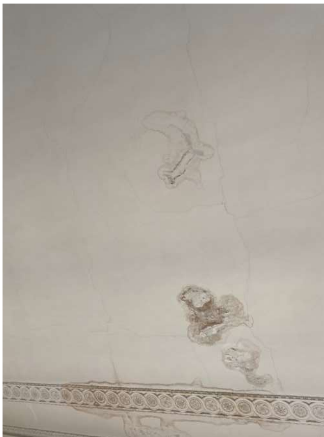
Фото 42. Разрушение, растрескивание, следы увлажнения отделочного слоя чердачного перекрытия в осях А-Б/2-3
