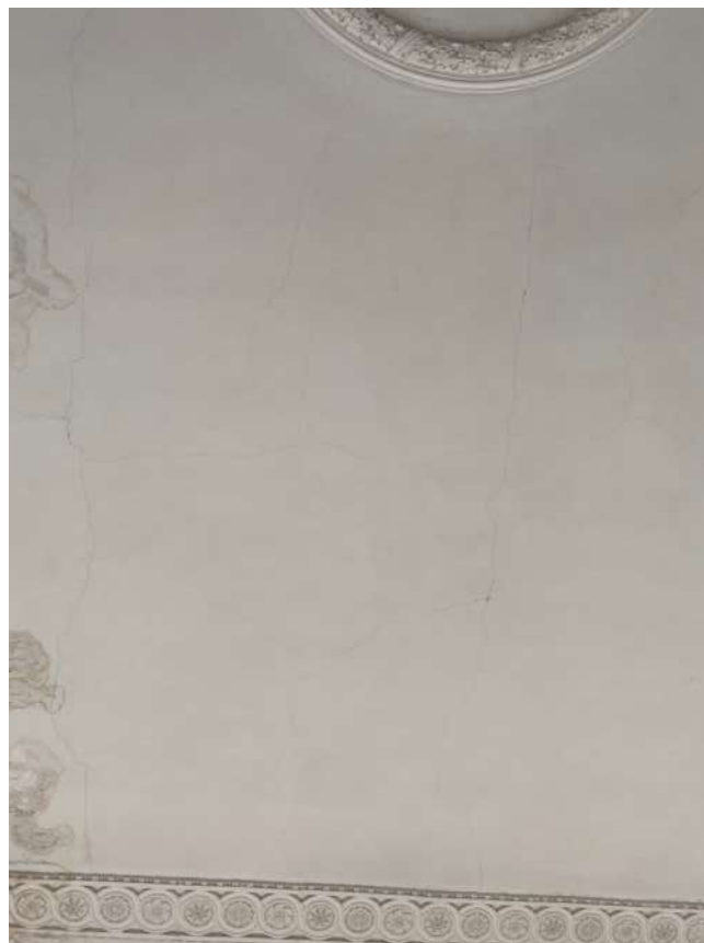
Фото 43. Растрескивание отделочного слоя чердачного перекрытия в осях А-Б/2-3
