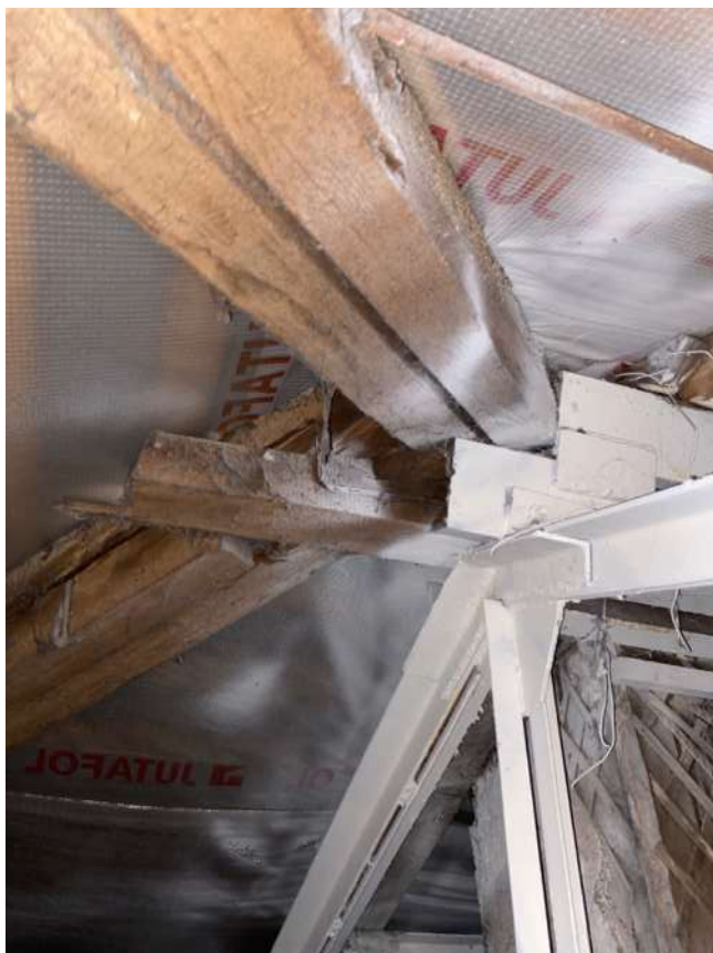
Фото 60. Общий вид узла опирания деревянных ендовых ног на металлическую ферму в осях В/2
