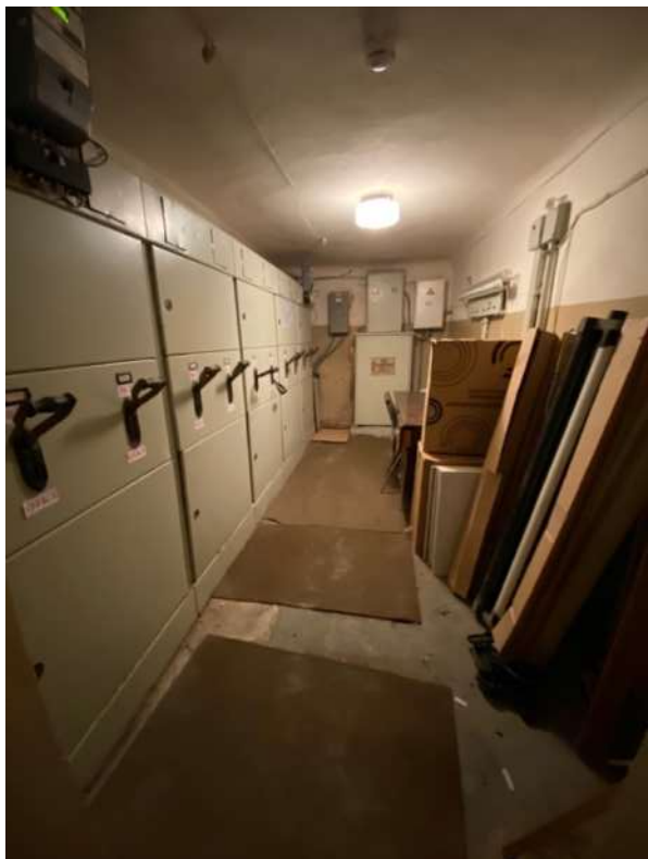
Фото 88. Общий вид электрощитовой
