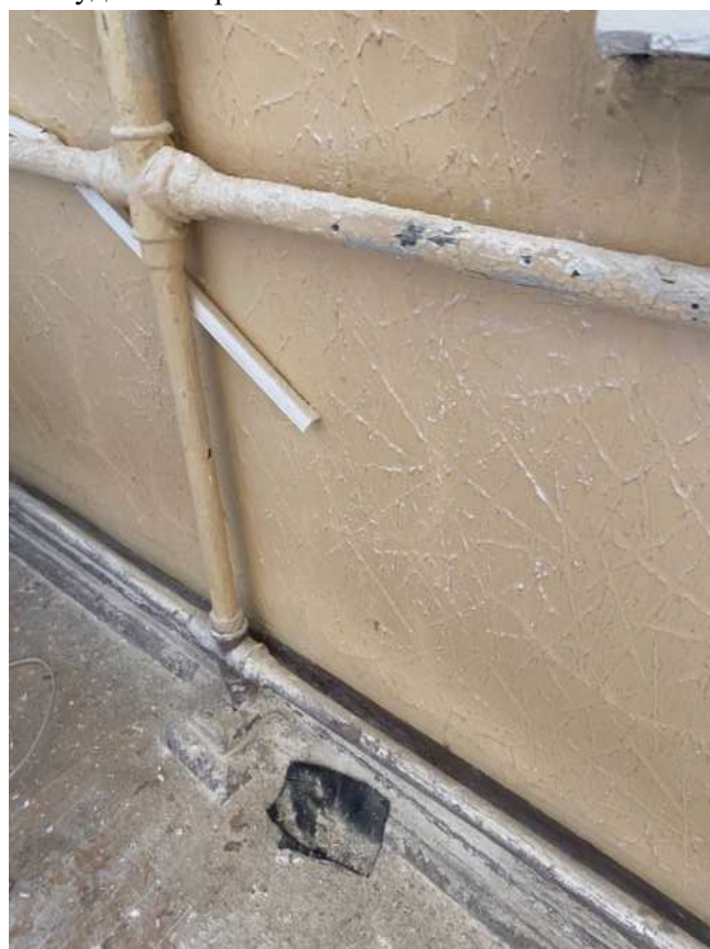
Фото 95. Разрушение окрасочного слоя отопительных труб
