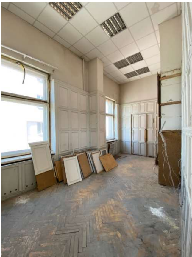
Фото 86. Износ покрытия пола из паркетной доски в осях А-В/1-2
