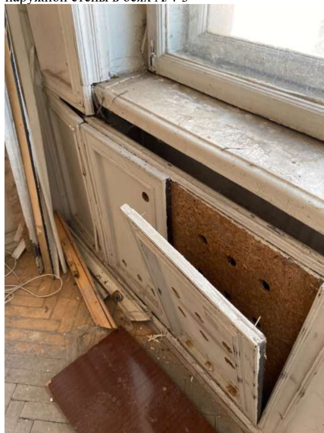
Фото 16. Разрушение деревянных элементов обшивки наружной стены в осях Б-В/1
