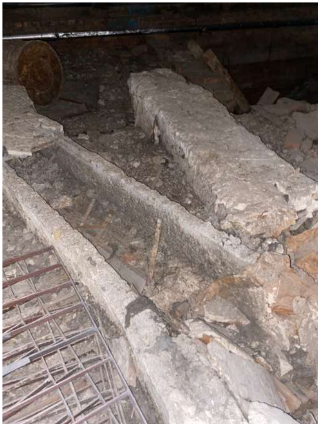
Фото 64. Разрушение бетонного вентиляционного канала в уровне чердака в осях Б-В/1-2
