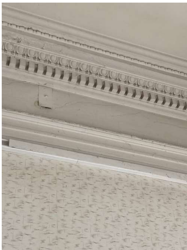
Фото 22. Растрескивание отделочного слоя внутренней стены в осях Б-А/4
