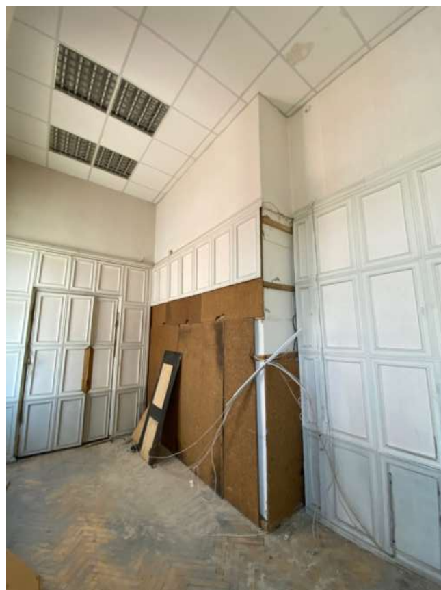
Фото 23. Разрушение деревянных элементов обшивки внутренней стены в осях В-Б/2
