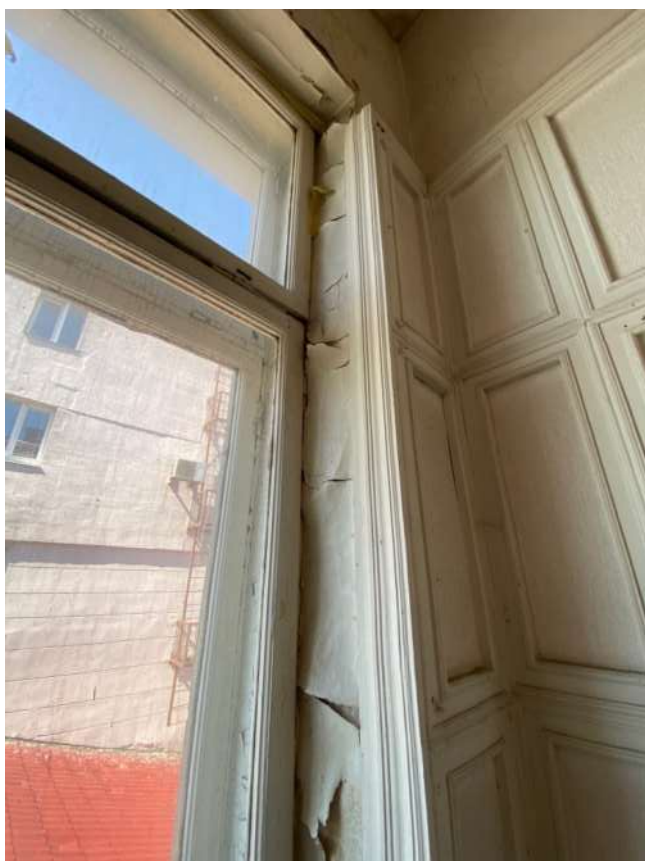
Фото 78. Разрушение отделочного слоя оконных откосов
