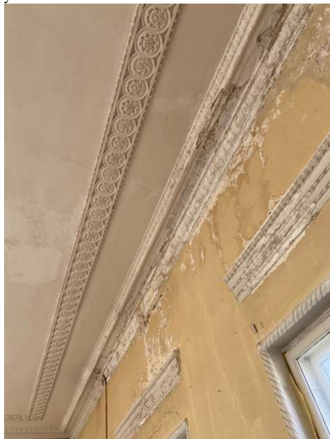
Фото 12. Разрушение, сколы, трещины отделочного слоя, декоративных элементов из гипсовой лепнины наружной стены в осях Г/2-3
