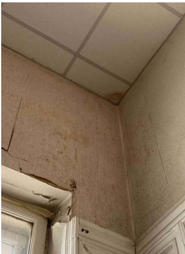
Фото 15. Отслоение обоев, следы увлажнения наружной стены в осях В/1
