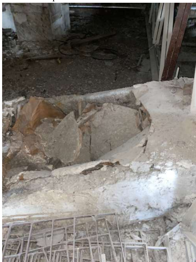
Фото 63. Разрушение бетонного вентиляционного канала в уровне чердака в осях В/2-3
