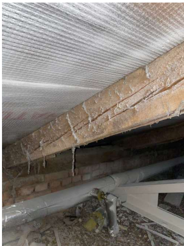
Фото 59. Продольные трещины деревянной стропильной ноги в осях А-Б/3-4
