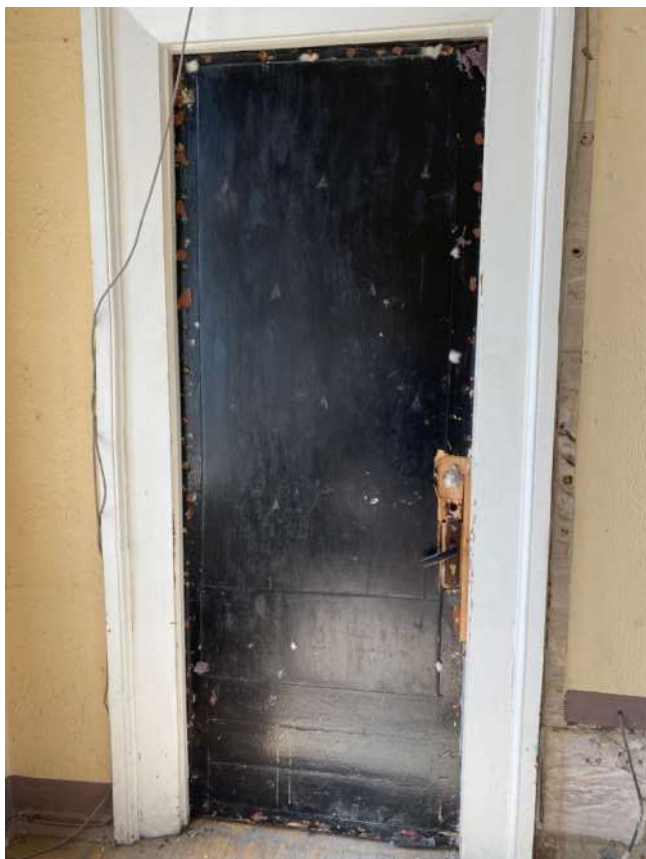
Фото 72. Износ, рассыхание деревянного дверного блока в осях А/2
