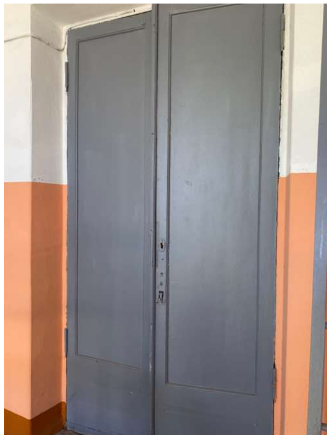
Фото 73. Фурнитура деревянного дверного блока в осях В/2-1 находится в неисправном состоянии
