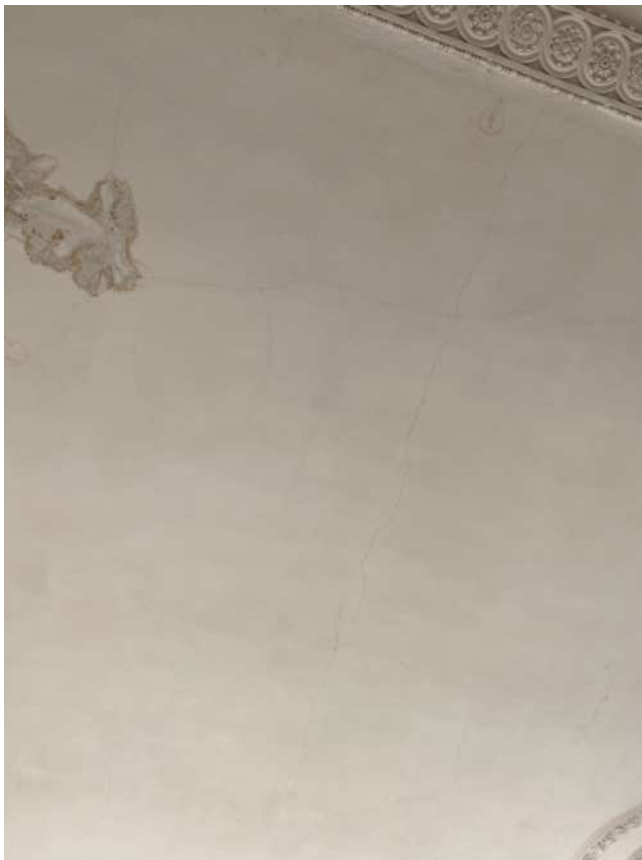
Фото 40. Растрескивание отделочного слоя чердачного перекрытия в осях В-Г/2-3
