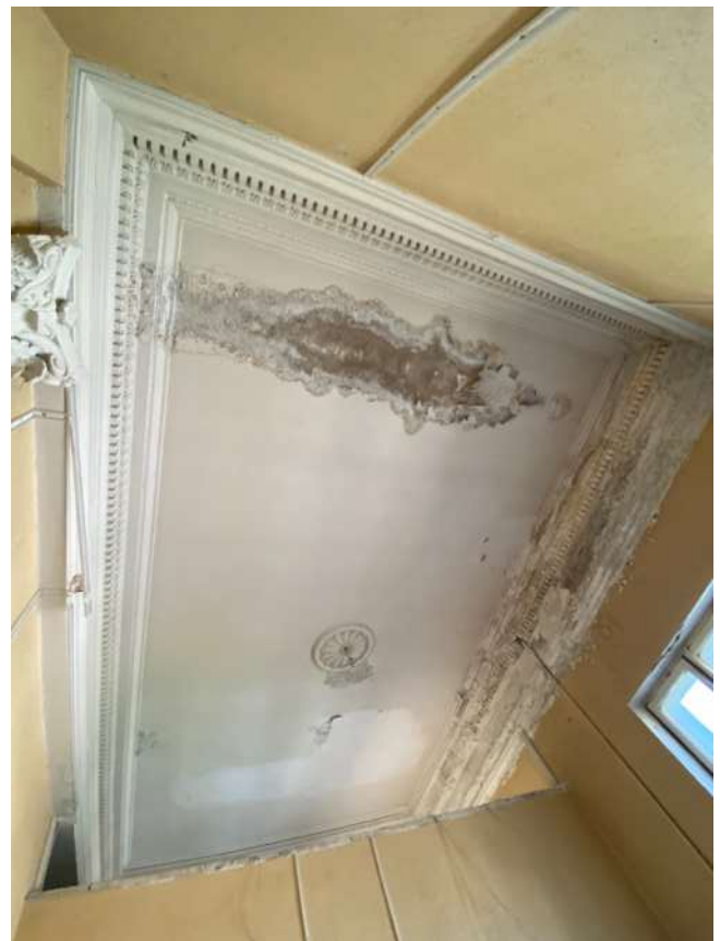
Фото 37. Разрушение, следы увлажнения отделочного слоя чердачного перекрытия в осях В-Г/3-4
