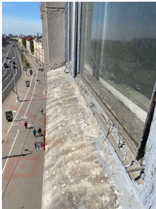
Фото 77. Разрушение окрасочного слоя, износ металлического отлива в осях А/2-3
