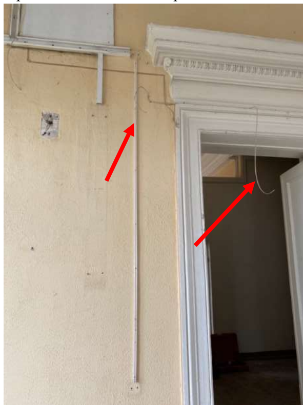
Фото 91. Элементы электропроводки находятся в неудовлетворительном состоянии
