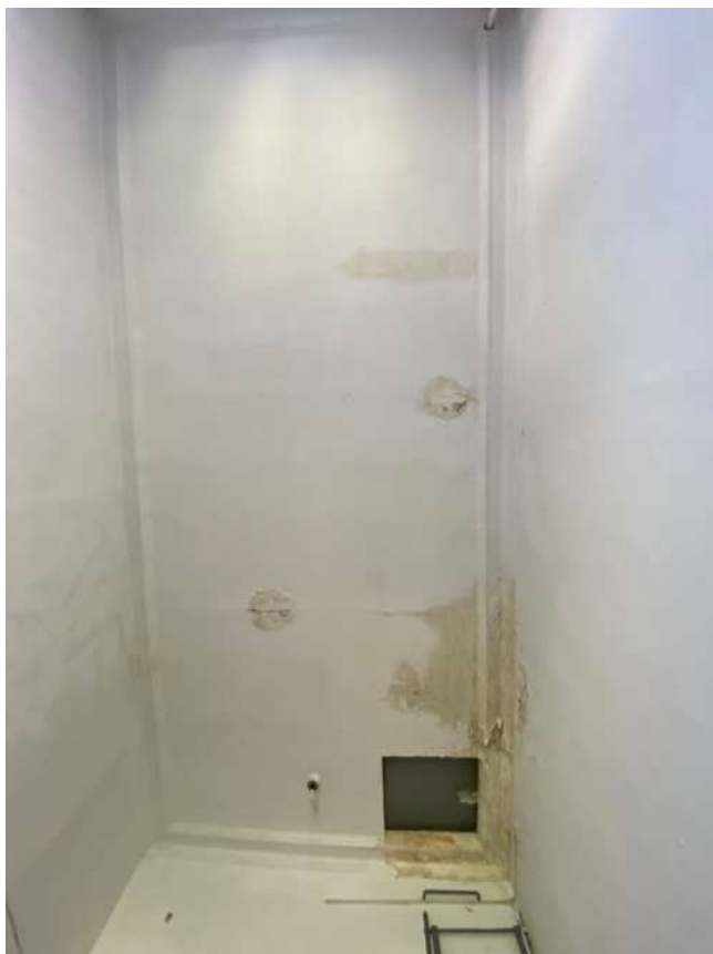
Фото 46. Разрушение, трещины, следы увлажнения отделочного слоя чердачного перекрытия в осях В-Д/1-2
