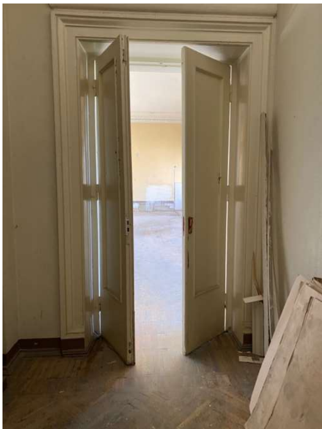
Фото 70. Отсутствуют элементы дверной фурнитуры в осях В-Г/3
