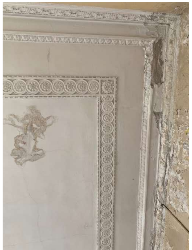
Фото 39. Разрушение, растрескивание, следы увлажнения отделочного слоя чердачного перекрытия в осях Г/3
