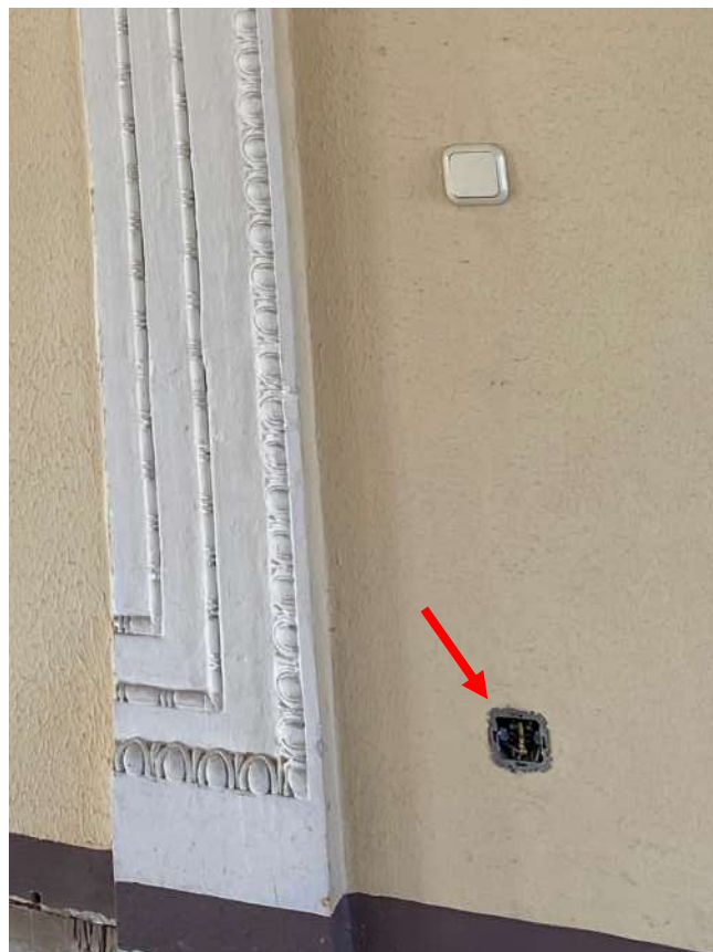
Фото 93. Элементы электропроводки находятся в неудовлетворительном состоянии
