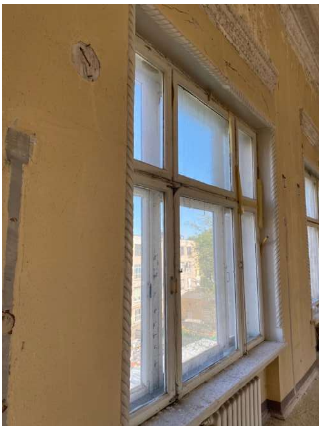
Фото 74. Разрушение окрасочного слоя, рассыхание деревянного оконного блока
