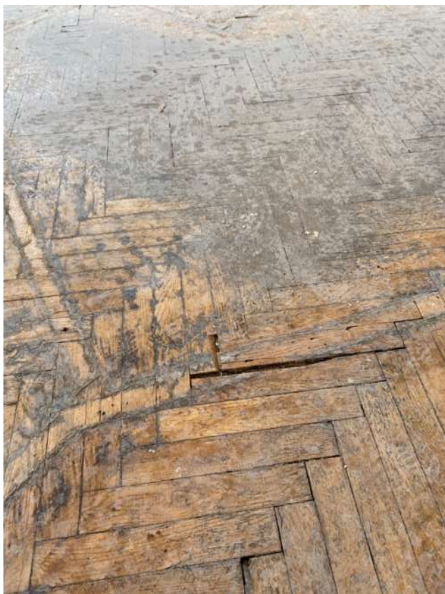
Фото 82. Износ покрытия пола из паркетной доски
