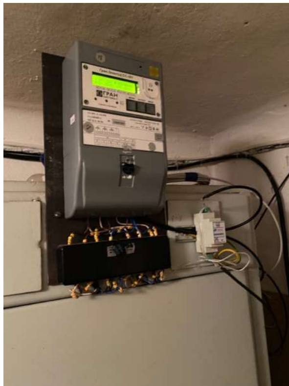
Фото 89. Общий вид счётчика электрической энергии в помещении электрощитовой
