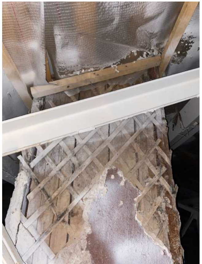
Фото 65. Разрушение отделочного слоя вентиляционной шахты в осях В/2-3
