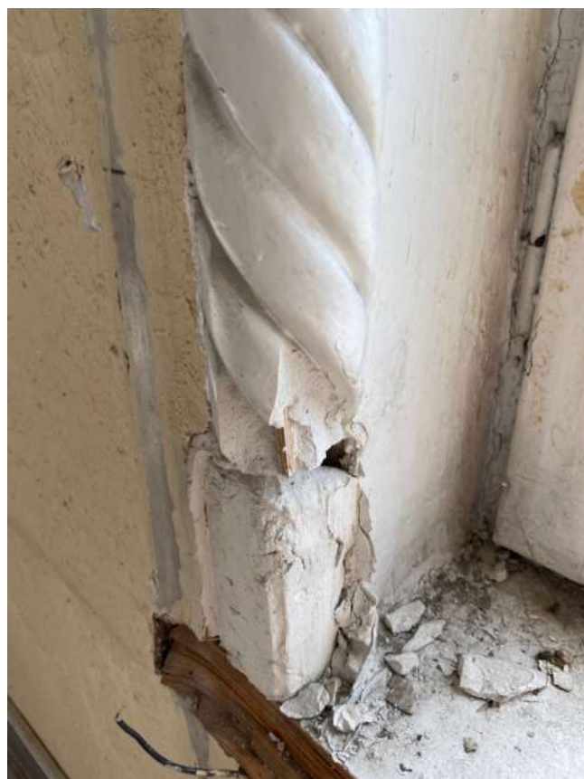
Фото 79. Сколы декоративного элемента из гипсовой лепнины по контуру оконного проема
