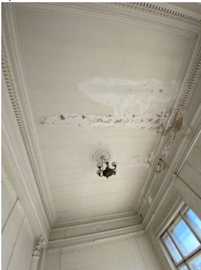
Фото 44. Разрушение, следы увлажнения отделочного слоя чердачного перекрытия в осях А-Б/3-4
