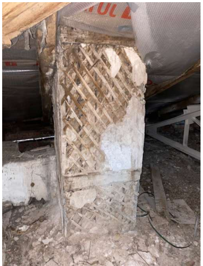
Фото 67. Разрушение отделочного слоя вентиляционной шахты в осях В-Г/2
