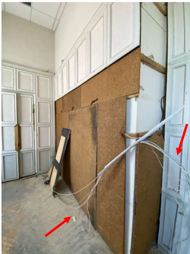
Фото 92. Элементы электропроводки находятся в неудовлетворительном состоянии
