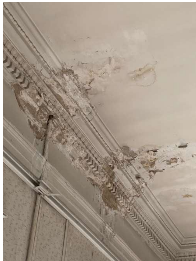
Фото 14. Разрушение, сколы декоративных элементов из гипсовой лепнины (карниза) наружной стены в осях А/4-3
