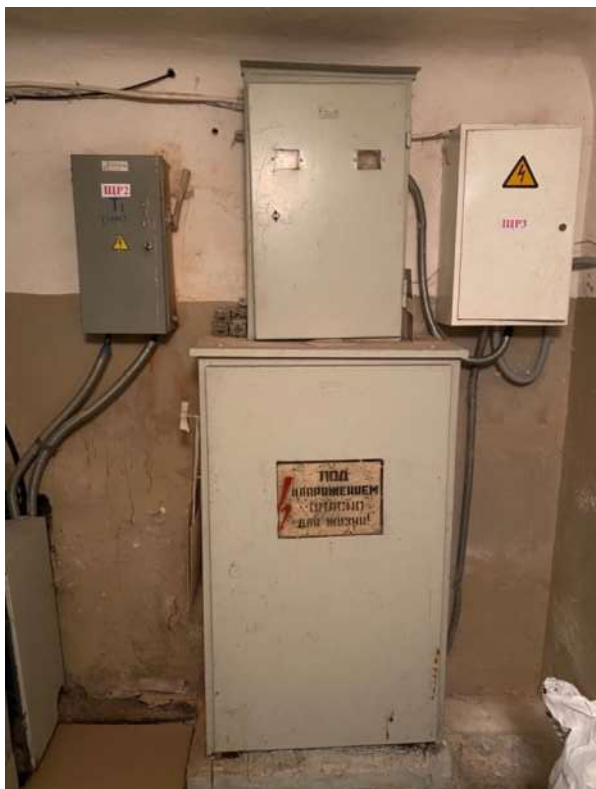
Фото 90. Общий вид распределительных щитов в помещении электрощитовой
