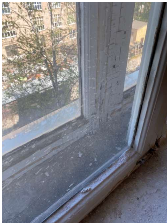
Фото 75. Разрушение окрасочного слоя, рассыхание деревянного оконного блока
