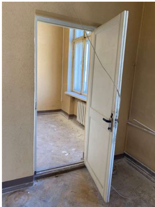
Фото 69. Фурнитура деревянного дверного блока в осях Г/3-4 находится в неисправном состоянии
