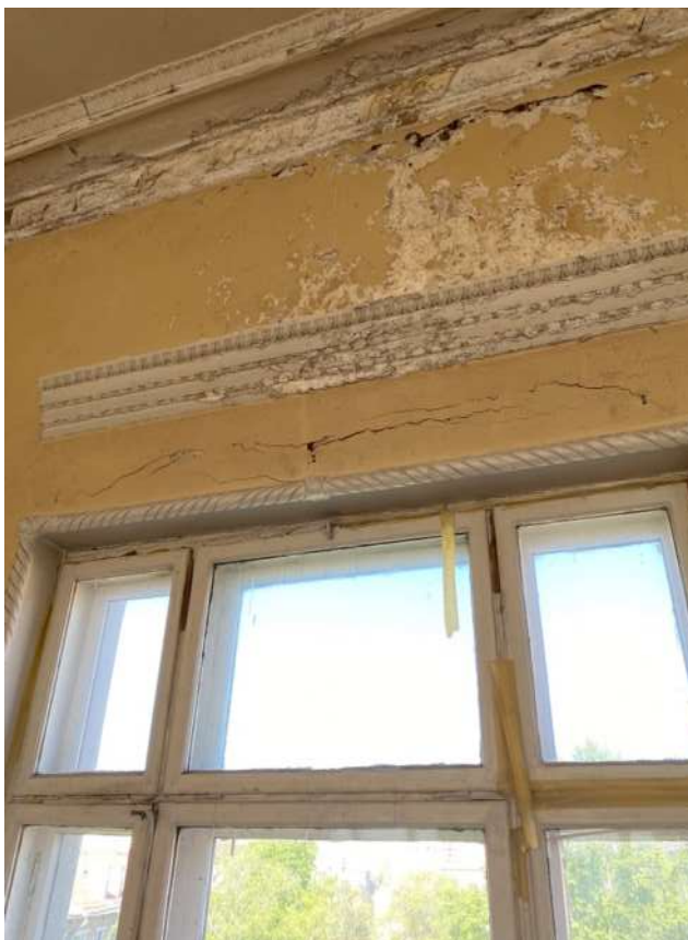
Фото 13. Трещины отделочного слоя над оконным проёмом наружной стены в осях Г/2-3
