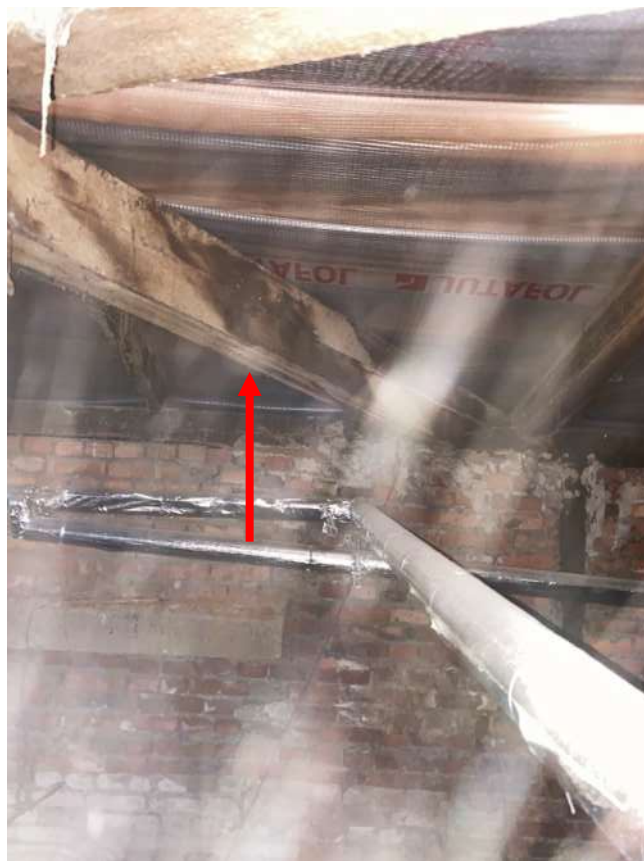
Фото 61. Следы увлажнения деревянных элементов стропильной системы в осях Г/1
