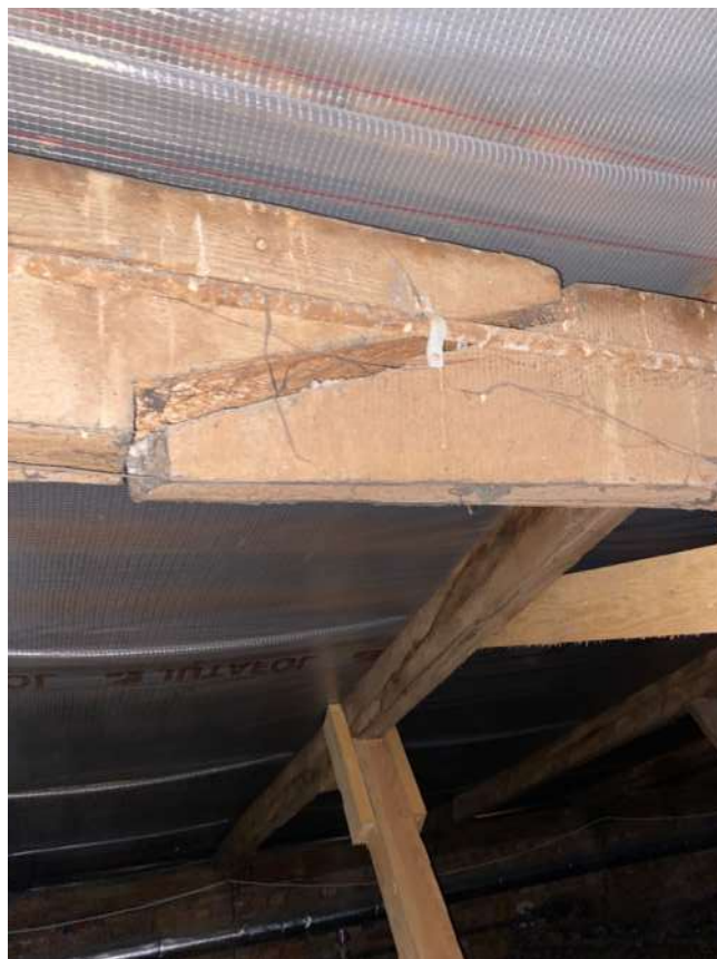
Фото 57. Отсутствуют элементы соединения деревянного прогона из брусьев 150x220(н)мм в осях А-Б/3-4
