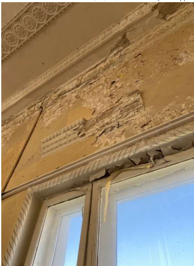
Фото 11. Разрушение, сколы, трещины отделочного слоя, декоративных элементов из гипсовой лепнины наружной стены в осях Г/2-3
